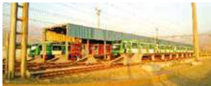
Ampliación de Vías en Patio Bayóvar Construcción de vías férreas para el estacionamiento de 5 trenes adicionales.
