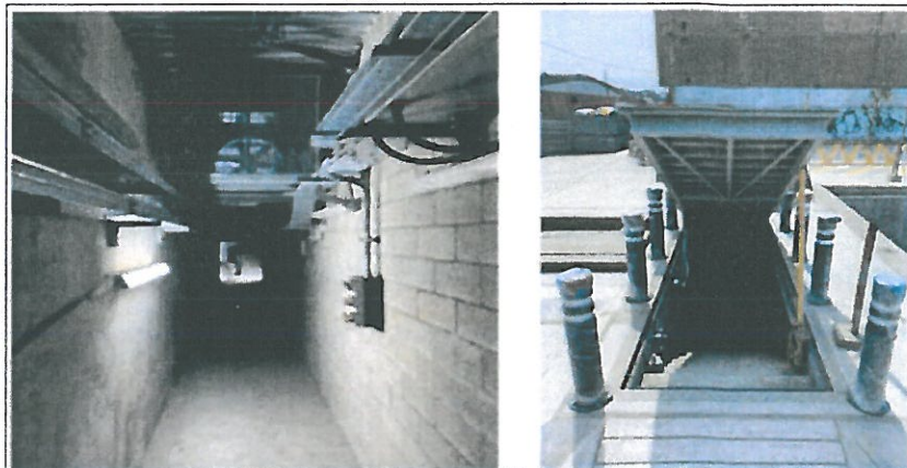
Imagen N° 7 Salidas de Emergencia
