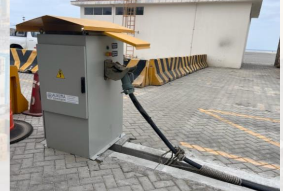
Alimentación eléctrica para eRTG
