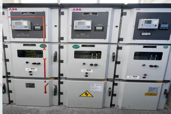
Alimentación eléctrica para Grúa STS 03
