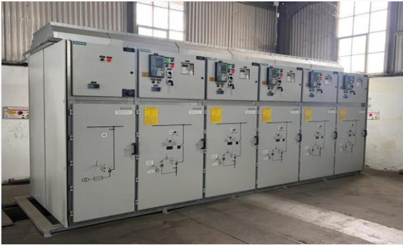
Celdas de Media Tensión para SED MSO
