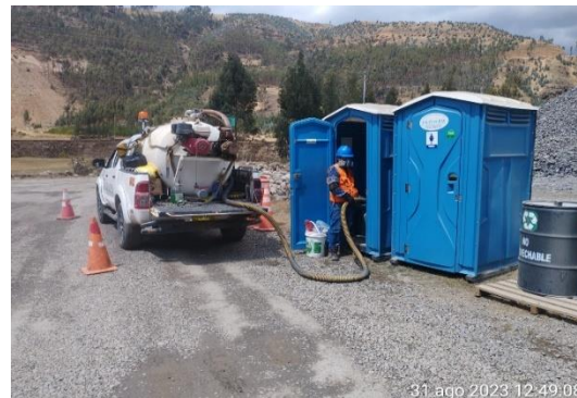
Limpieza de baños y recolección de efluentes
