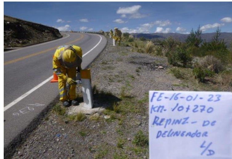
Deterioro delineador (cinta reflectiva)
