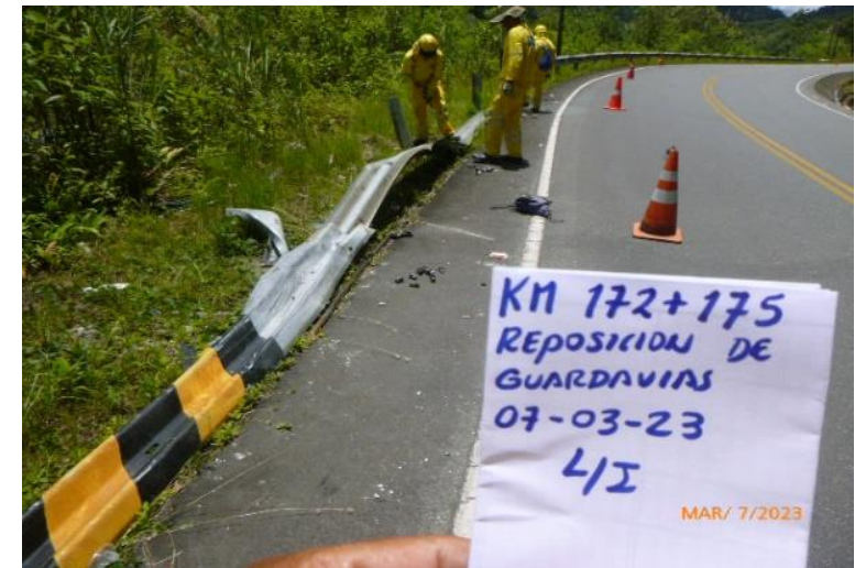
Reposición de guardavías
