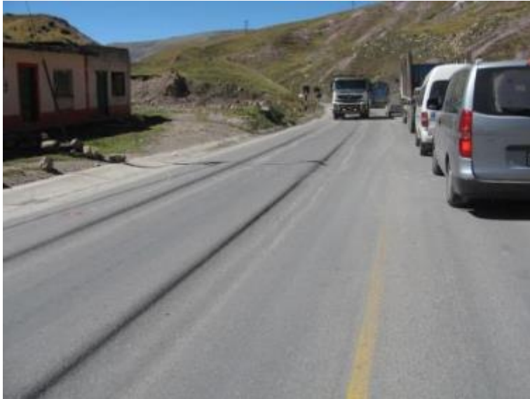
Ahuellamientos de hasta 11 cm
