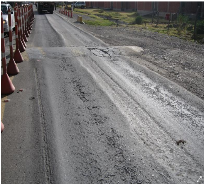
Ahuellamientos previo rompemuelle
