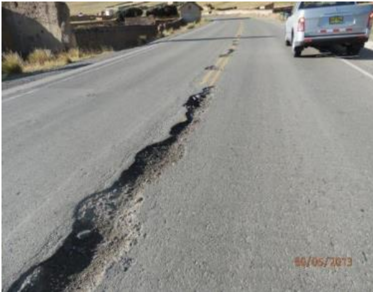
Baches de más de 5 m. de longitud
