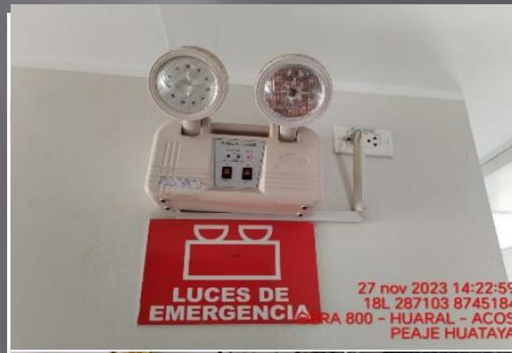
Luces de Emergencia
