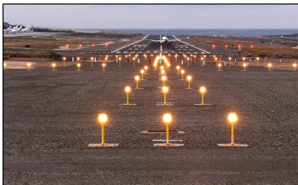
Imagen N° 1 Sistema de luces de aproximación
