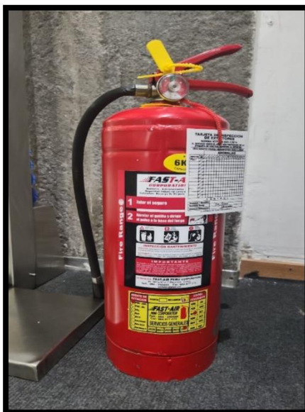
Imagen N° 2: Extintor Oficina Desconcentrada del Ositrán en Cusco
