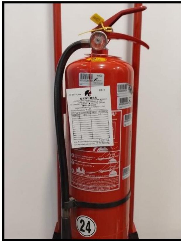
Imagen N° 4: Equipo de extintor Oficina Desconcentrada del Ositrán en Arequipa
