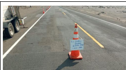
Peladuras - Antes Sector 1: San Juan - Emp. Panamericana Progresiva: KM 000+700 - 000+800
