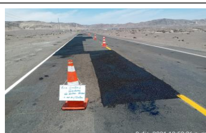
Peladuras - Después Sector 1: San Juan - Emp. Panamericana Progresiva: KM 000+700 - 000+800
