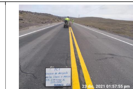
Exceso de desgaste en las líneas o marcas(3 líneas) - Durante Sector 3: Dv. Nazca - Dv. Pampachiri Progresiva: KM 237+000 - 237+500
