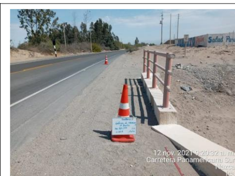
Limpieza de baranda de puente - Antes Sector 2: Emp. Panamericana - Nazca Progresiva: KM 465+375 - 465+375
