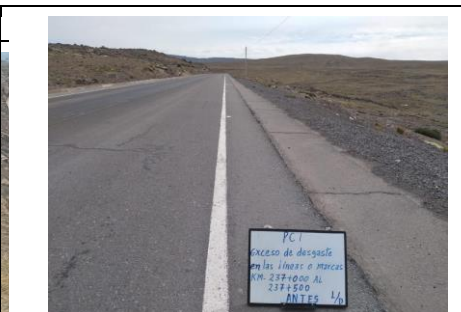
Exceso de desgaste en las líneas o marcas(3 líneas) - Antes Sector 3: Dv. Nazca - Dv. Pampachiri Progresiva: KM 237+000 - 237+500
