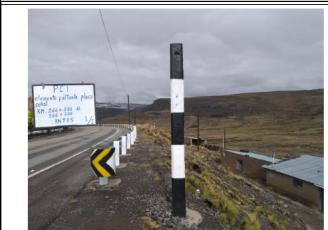
Elementos faltantes - Antes Sector 4: Dv. Pampachiri - Chalhuanca Progresiva: KM 366+500 - 266+500
