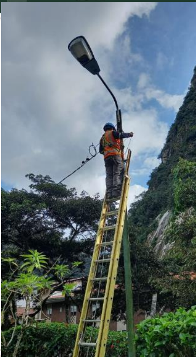
ILUMINACIÓN EXTERIOR MACHUPICCHU
