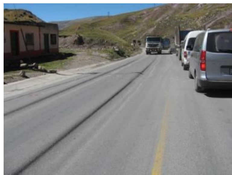
Ahuellamientos de hasta 11 cm
