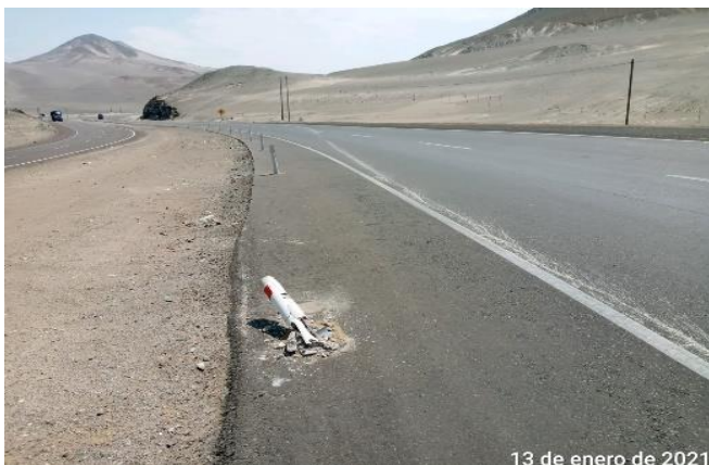
Deterioro de delineadores NS - LI, Km. 337+120 - Antes
