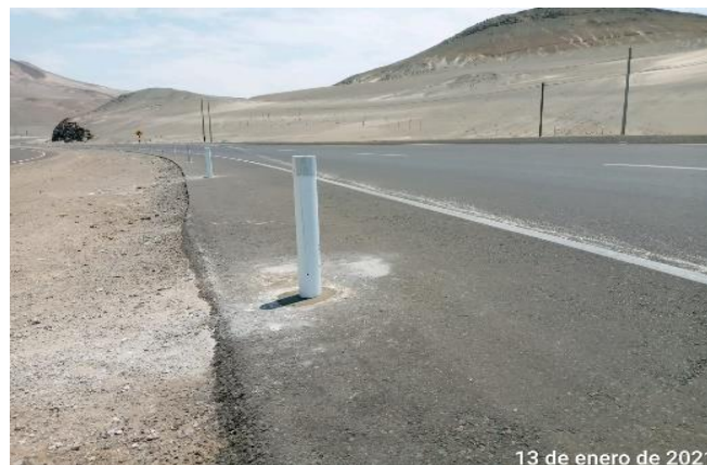
Deterioro de delineadores NS - LI, Km. 337+120 - Después
