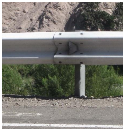
Elementos faltantes - pernos
