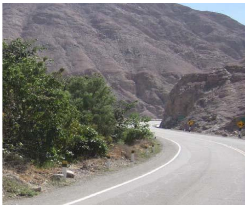
Exceso de altura de vegetación
