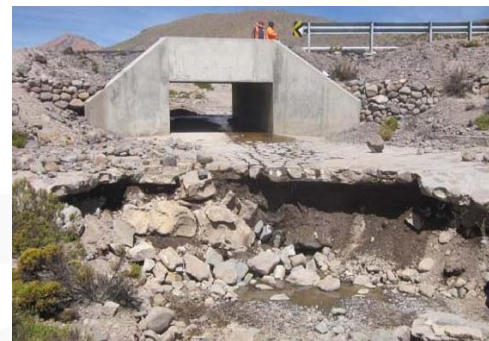
Falla estructural - Socavación
