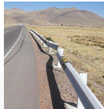
Deterioro de las defensas metálicas
