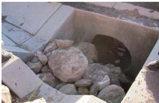
Obstrucción al libre escurrimiento
