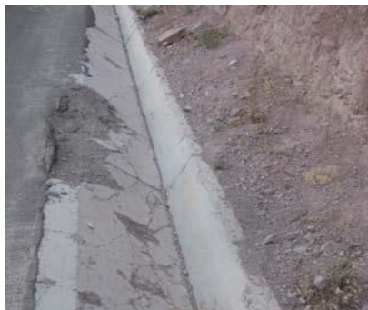
Falla estructural cuneta
