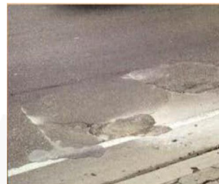
Parches en mal estado, huecos
