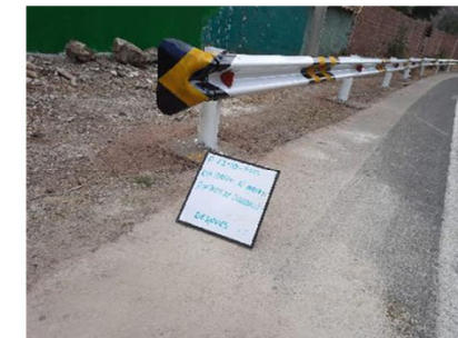
Deterioros y limpieza de las defensas metálicas - Después Sector 9: Cusco - Urcos Progresiva: km 1012+741 - km 1012+856
