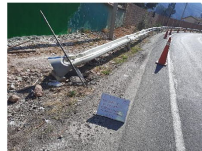
Deterioros y limpieza de las defensas metálicas - Antes Sector 9: Cusco - Urcos Progresiva: km 1012+741 - km 1012+856
