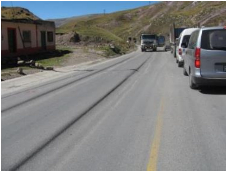
Ahuellamientos de hasta 11 cm
