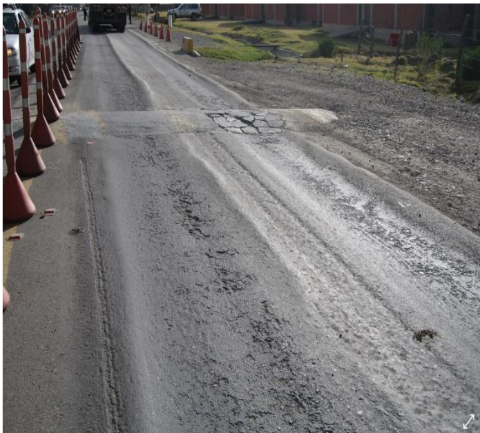
Ahuellamientos previo rompemuelle
