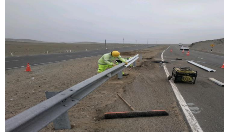
Reposición de guardavías
