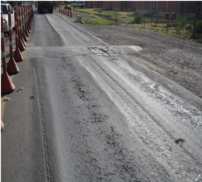
Ahuellamientos previo rompemuelle
