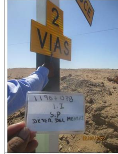
1190+078 – PCI 018-2022 No se puede observar el deterioro del mensaje es completamente legible
