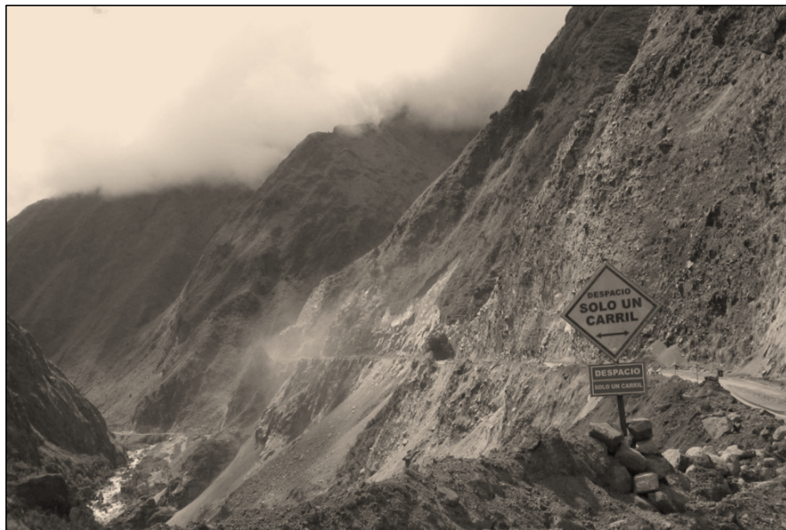
Sector Crítico Soccostaca (antes)
