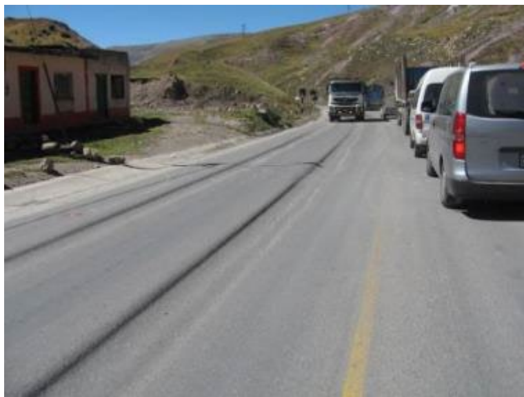
Ahuellamientos de hasta 11 cm
