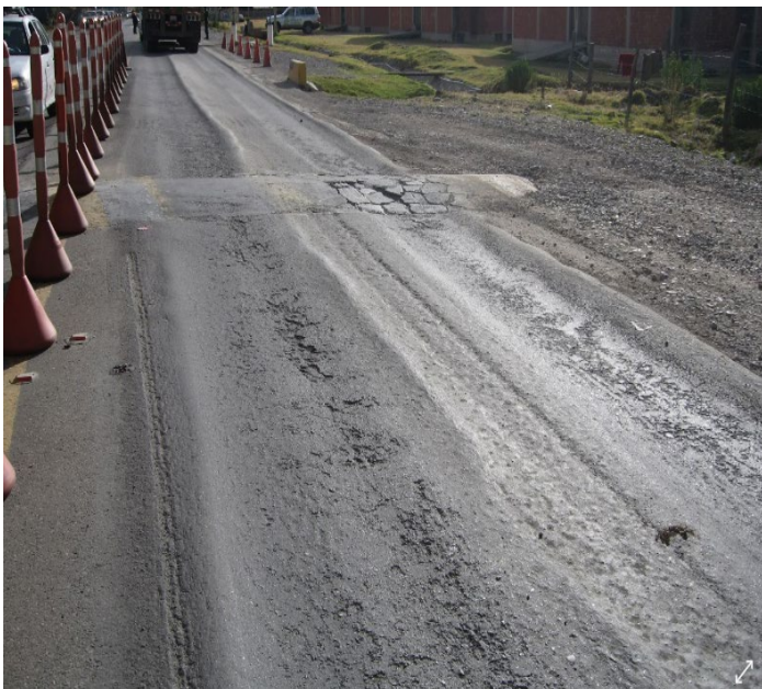
Ahuellamientos previo rompemuelle
