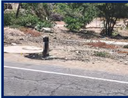
Deterioro de hitos km
