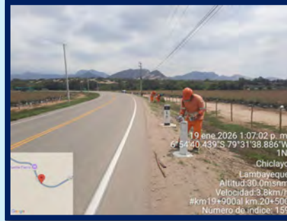
Deterioro delineador (cinta reflectiva)
