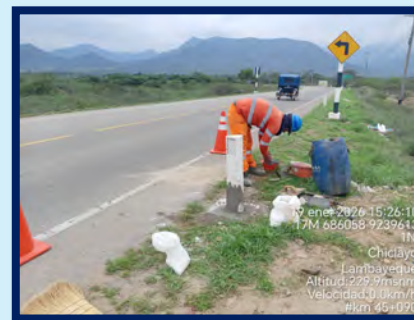
ELEMENTOS FALTANTES (REPOSICION)
