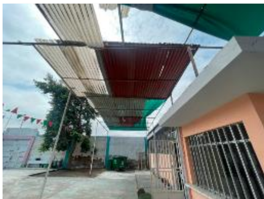
Fisuras en techos, infraestructura dañada por el salitre
