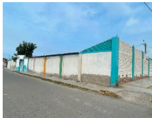
Infraestructura dañada por el salitre
