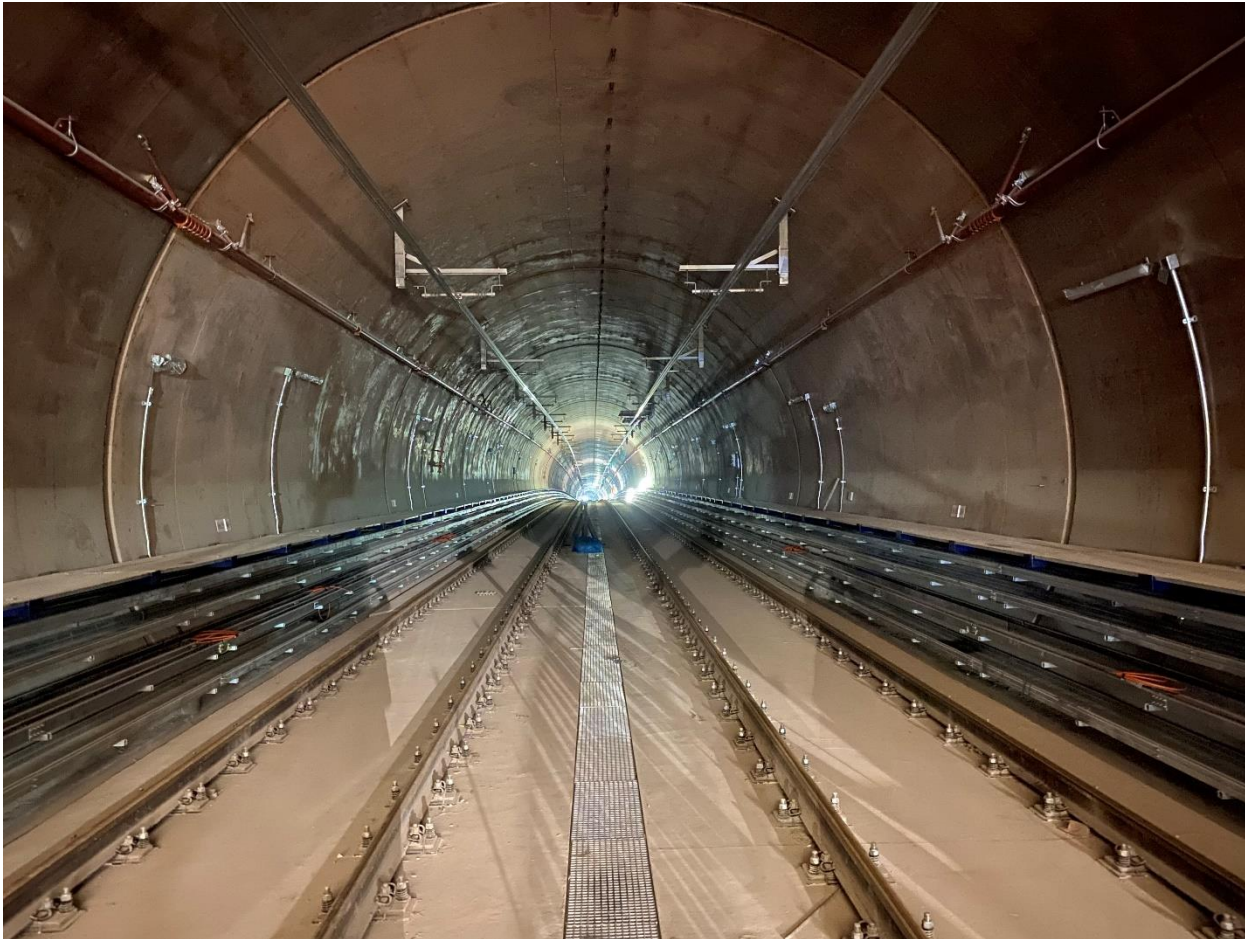
Bandejas e instalación contraincendios
