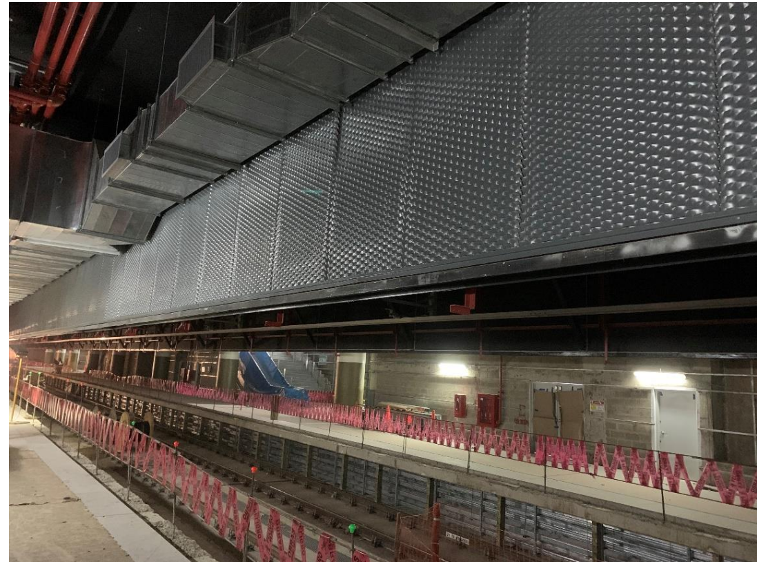
Instalaciones en área de andén.
