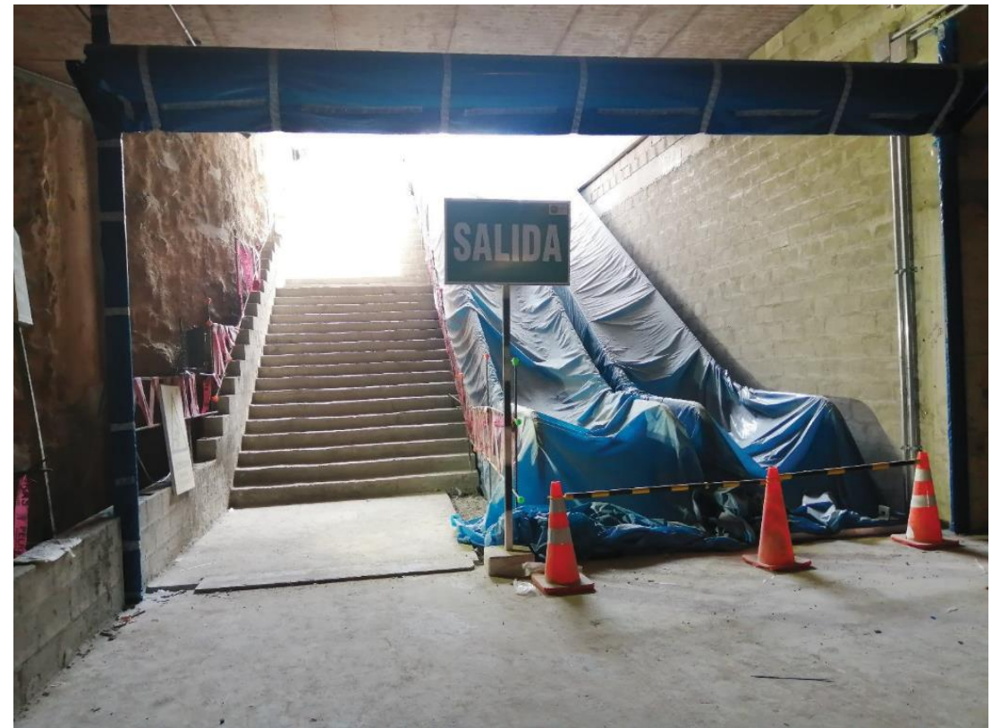
Escalas mecánicas colocadas en acceso
