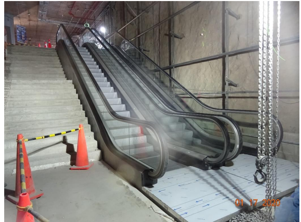
Escalas mecánicas en pre-vestíbulo
