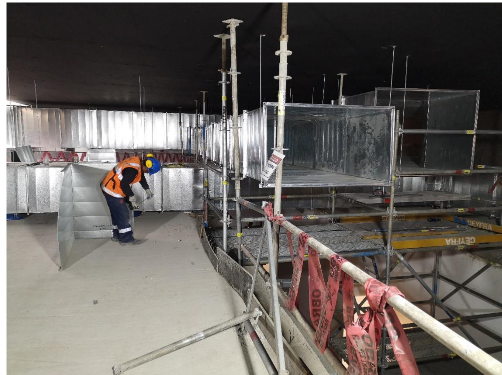
Ductos de Ventilación
