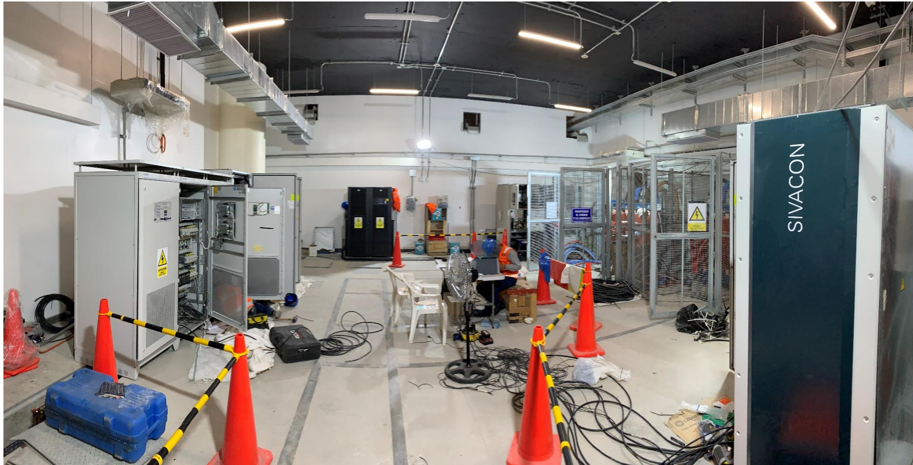
Cabina Eléctrica en Estación E-22
