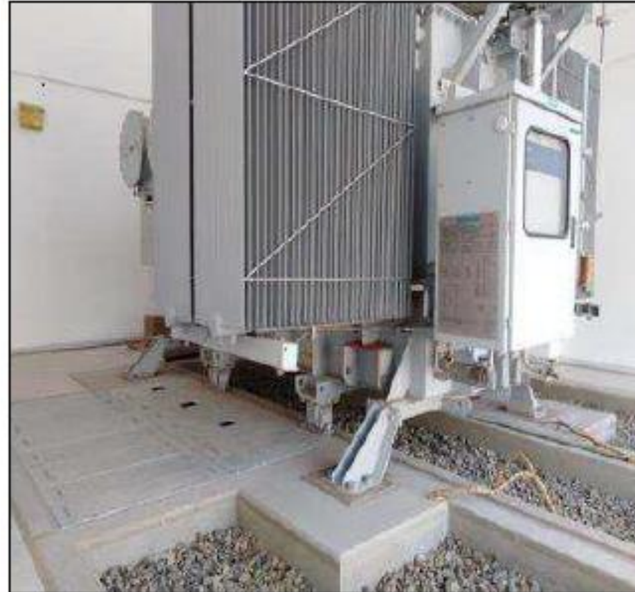
Anclaje antisísmico de transformador
