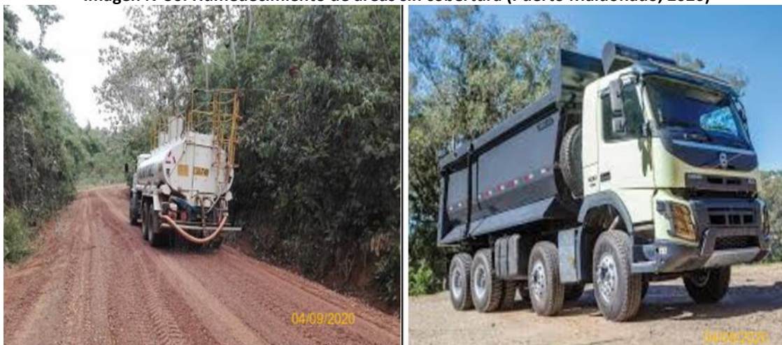
Imagen N°36: Humedecimiento de áreas sin cobertura (Puerto Maldonado, 2020)
