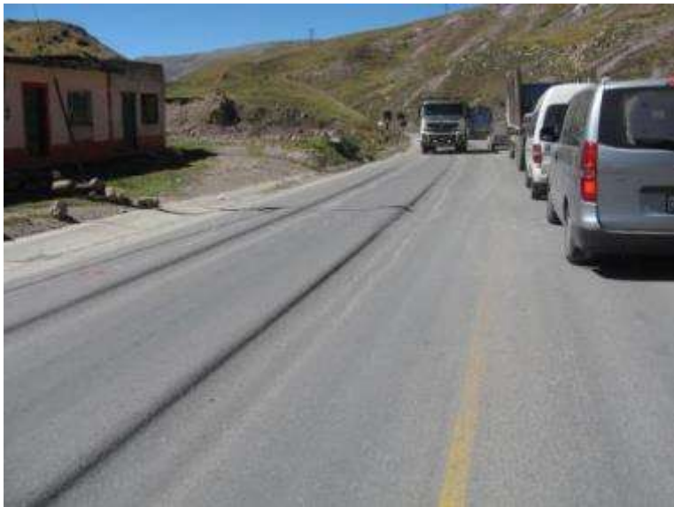
Ahuellamientos de hasta 11 cm
