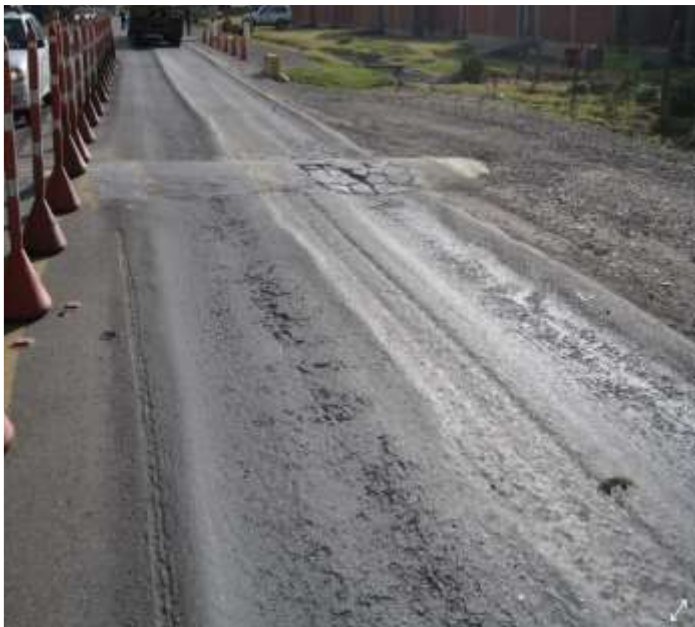
Ahuellamientos previo rompemuelle
