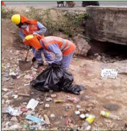
Limpeza de basurales en el derecho de vía - Durante Sector 1: Empalme 1B - Buenos Aires Progresiva: 14+940
