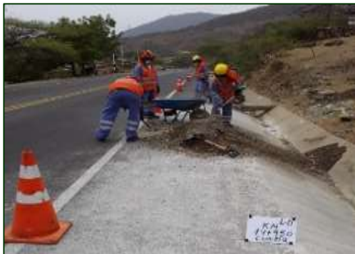
Limpeza de cunetas Manual No Colmatada - Durante Sector 1: Empalme 1B - Buenos Aires Progresiva: 14+950
