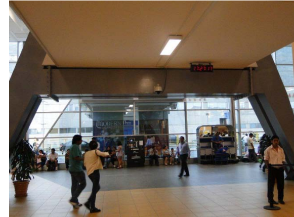
Cámaras Domo en Hall
