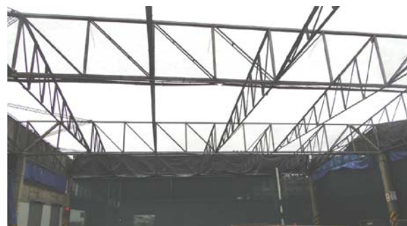
Se puede apreciar el techo en mal estado
