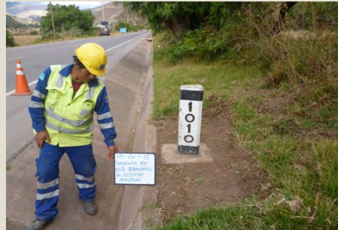
Deterioro de los postes kilométricos (vegetación) – Después Sector 9: Cusco - Urcos
