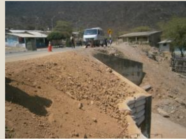
Conformación de talud en alcantarilla - Después Sector 1: Panamericana Norte Antigua – Buenos Aires
