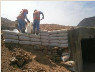
Conformación de talud en alcantarilla - Antes Sector 1: Panamericana Norte Antigua – Buenos Aires
