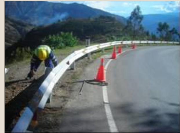
Reposición de Guardavías
