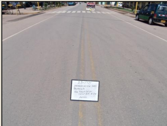
Demarcación de pavimento, Antes Progresiva: 943+600 – 943+800 Sector 8
