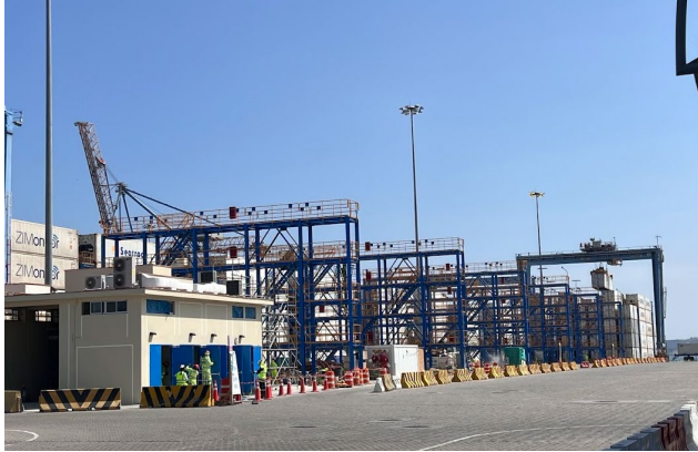
Ampliación de Reefers Racks
