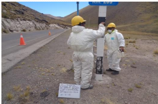
Deterioro y limpieza de los soportes de señal-Antes Sector 4: Dv. PampaChiri - Chalhuanca
