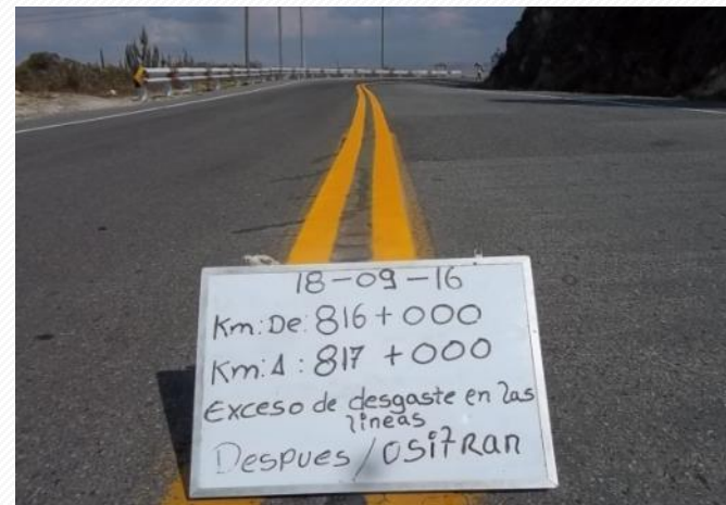
Deterioro Marcas en Pavimento - Después Sector 7: Abancay – Pte. Cunyac
