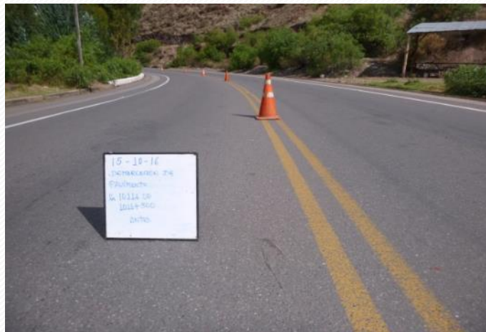
Deterioro Marcas en Pavimento - Antes Sector 9: Cusco - Urcos
