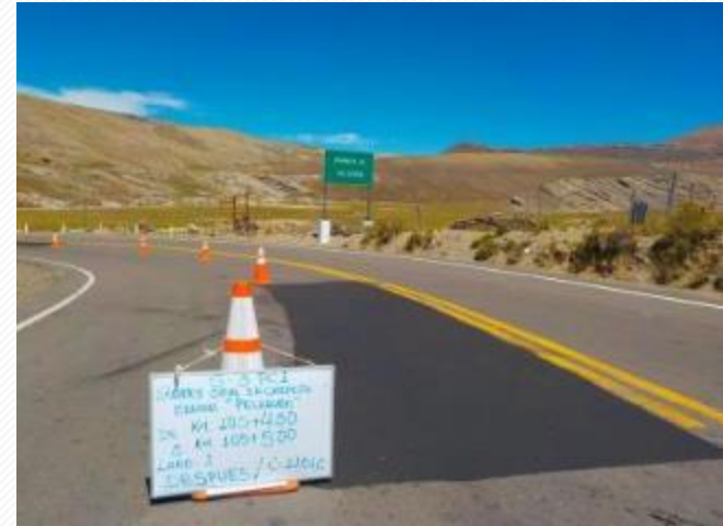
Peladuras - Después Sector 3: Nazca - Dv. PampaChiri
