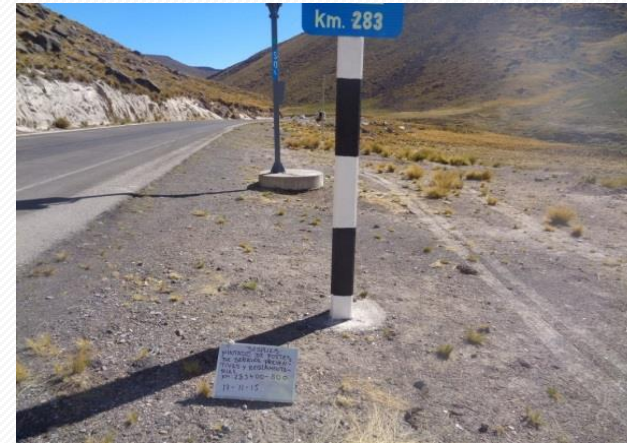
Deterioro y limpieza de los soportes de señal –Después Sector 4: Dv. PampaChiri - Chalhuanca
