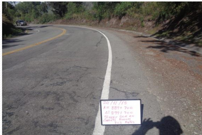
Tratamiento de peladuras - Antes Sector 8: Pte Cunyac - Cusco
