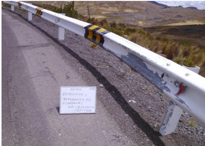
Deterioro y limpieza de defensas metálicas - Antes Sector 3: Nazca - Dv. PampaChiri
