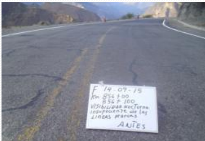
Deterioro Marcas en Pavimento - Antes Sector 7: Abancay – Pte. Cunyac
