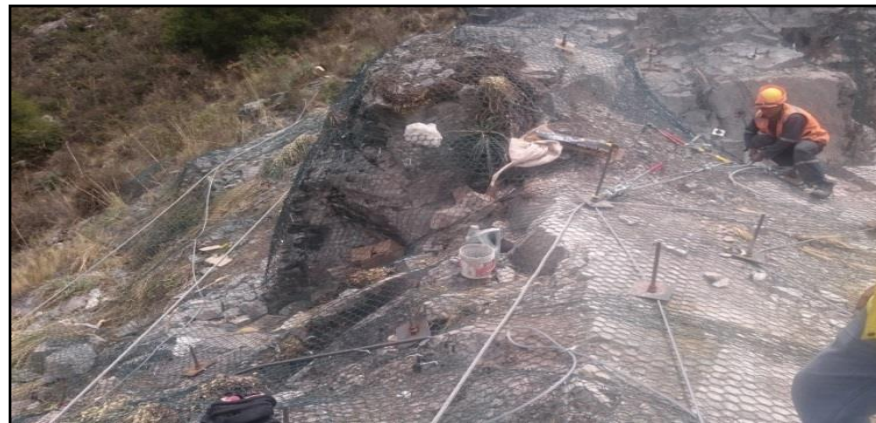
Suministro e Instalación de cable de acero de 3/4" en el perímetro y cuerpo del talud.
