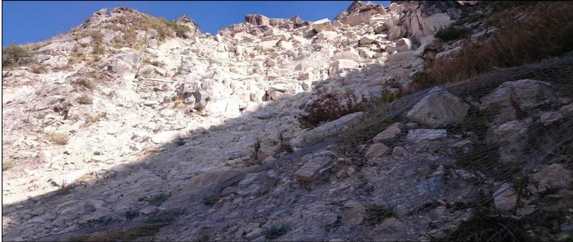
Vista Panorámica del Talud Rocoso antes de iniciar los trabajos de Enmallado.
