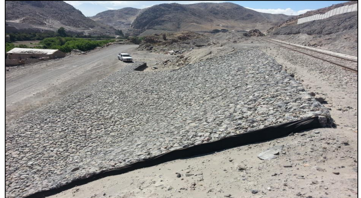
Proceso Constructivo del Muro de Gaviones: 220.50 m 3 Y Colchones de Protección: 104.60 m 3
