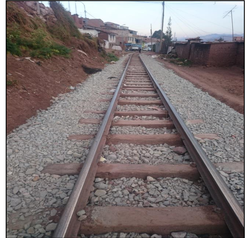
Estado Actual de la vía del km 02+200 al km 03+000
