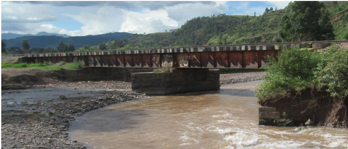
Puente Pichoc estado inicial.
