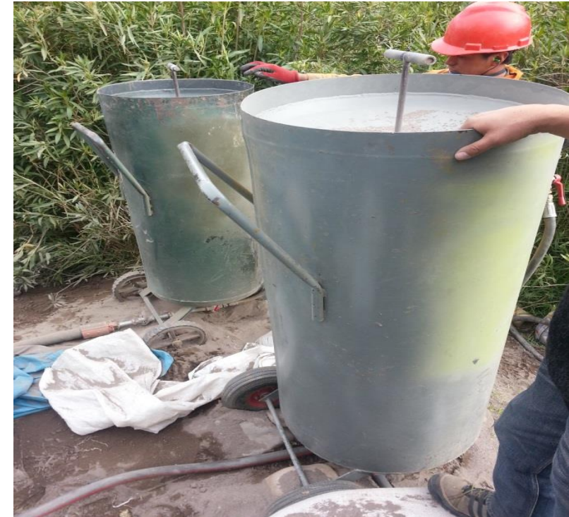
Tanques para el abastecimiento de arena al sistema de chorro abrasivo.
