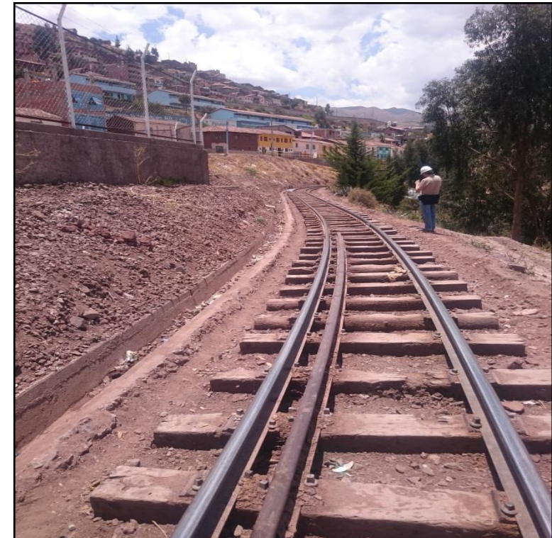
Estado Actual de la vía del km 06+340 al km 06+990
