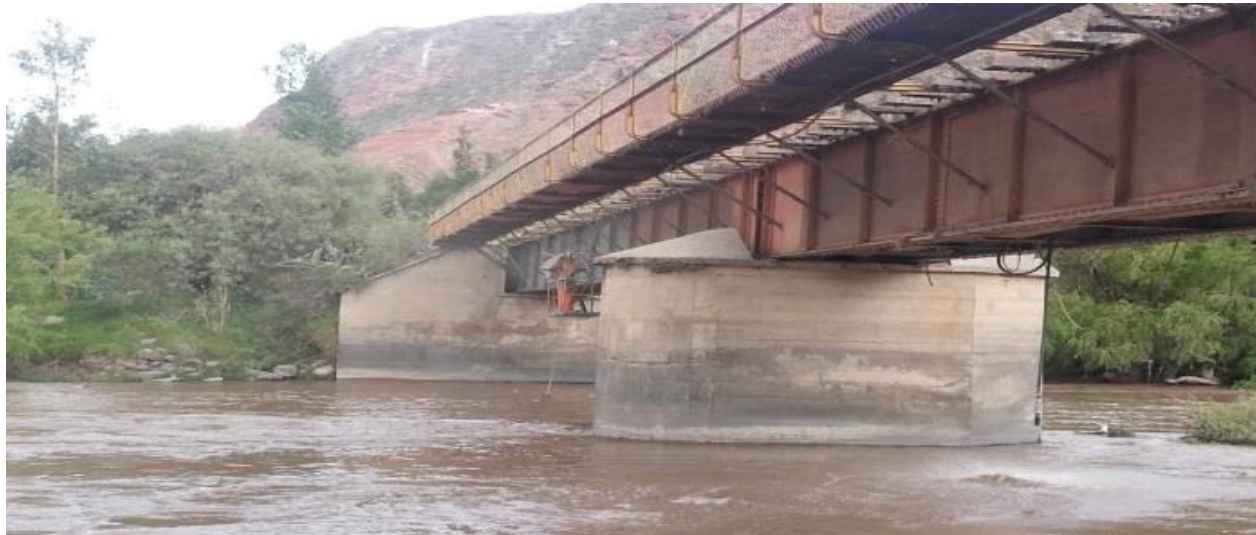
Puente Muyoc estado inicial.
