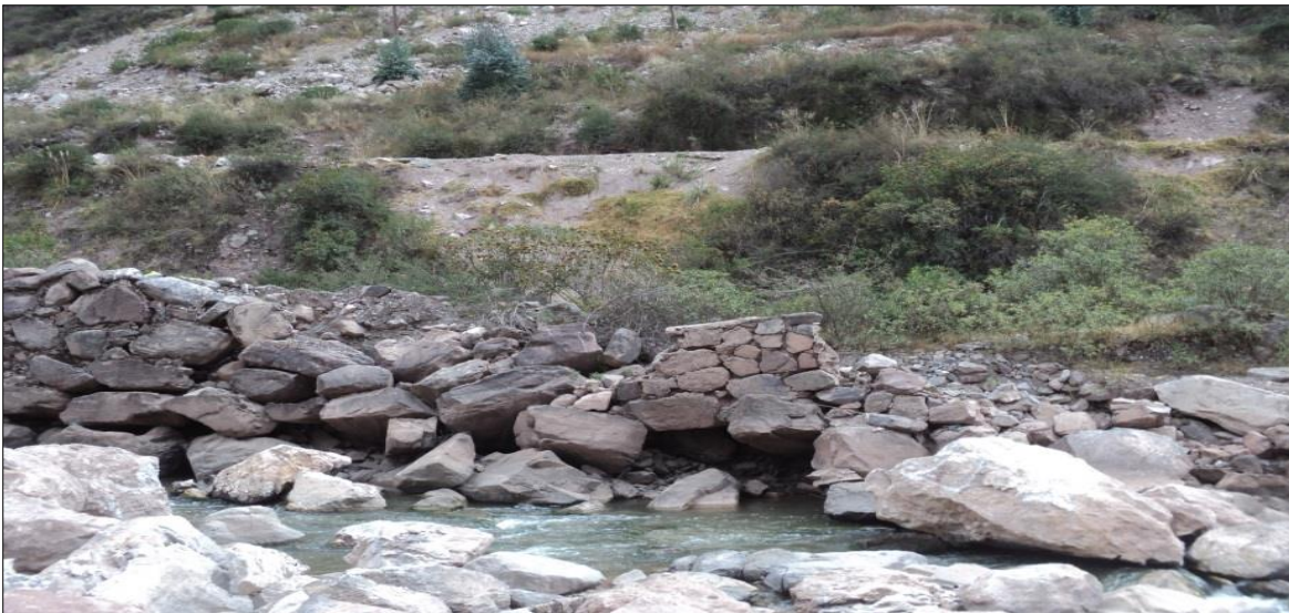
Situación Inicial del Muro.
