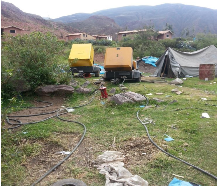
Impulsión de aire mediante compresoras.
