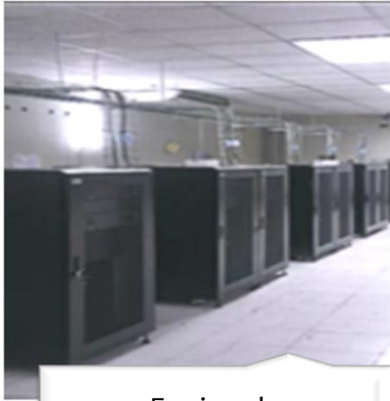
Equipo de Comunicaciones
