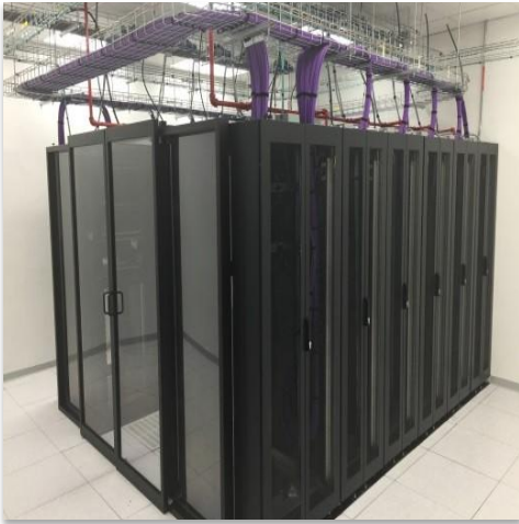
Salas de Servidores
