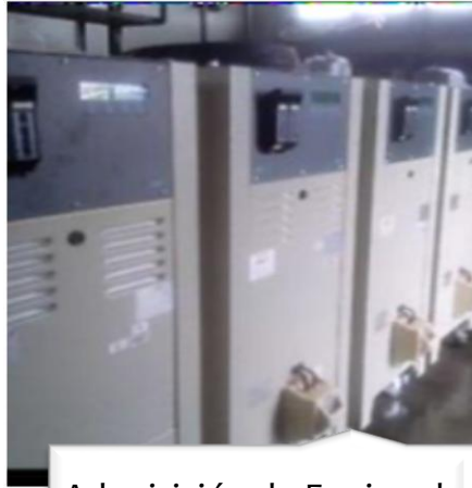
Adquisición de Equipo de Electricidad
