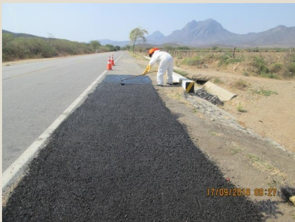
Bacheo en berma - Antes Sector 2A: Buenos Aires - Malacasi Progresiva: 22+350
