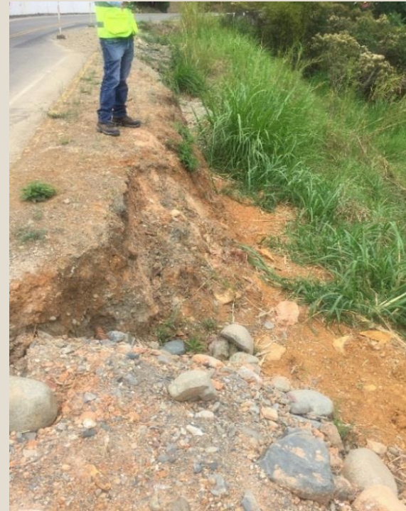
6. Desplazamiento de talud inferior Km 75+600
