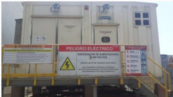
Señalización de Áreas de Trabajo
