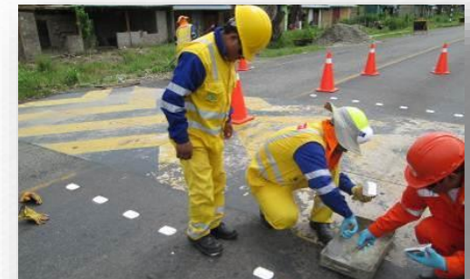
REPOSICIÓN DE TACHAS
