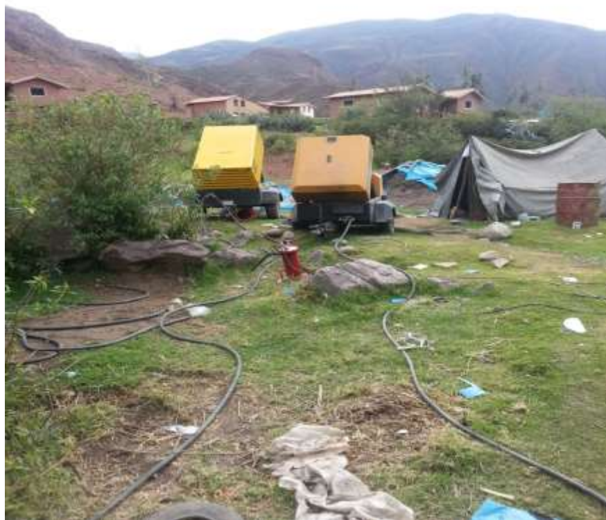
Impulsión de aire mediante compresoras.
