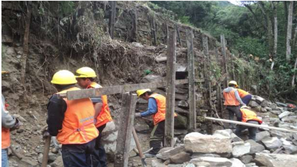
Desmontaje de muro seco con rieles, este muro estaba a punto de colapsar.
