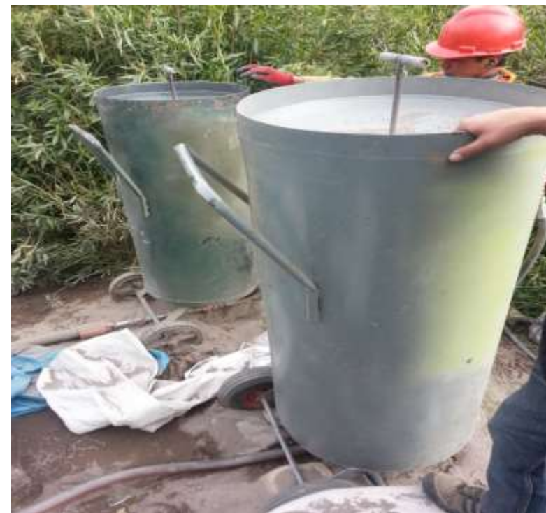
Tanques para el abastecimiento de arena al sistema de chorro abrasivo.
