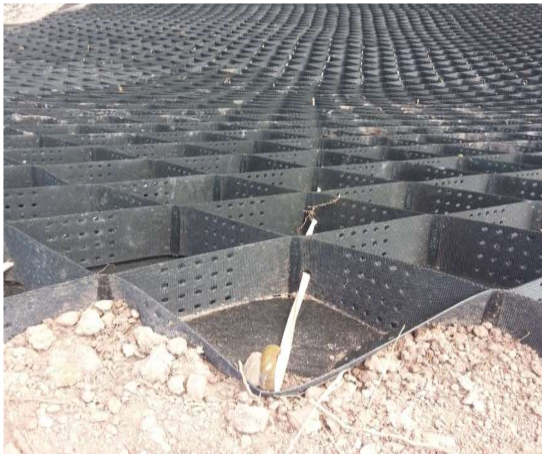
Uso de Geoceldas para proteger el talud, y facilitar la vegetación del mismo. Fijación de las geoceldas con estacas de fierro corrugado.
