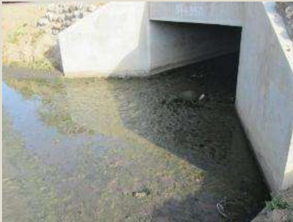
Limpieza de alcantarilla - Antes Sector 2A: Buenos Aires - Malacasi
