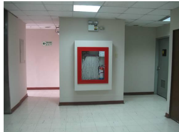
Sistema de extinción
