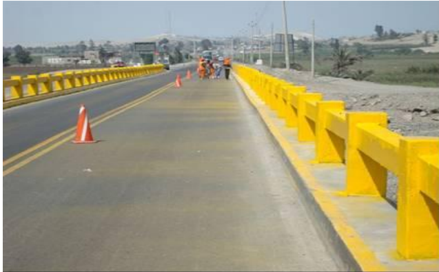
En la vista se puede observar al personal realizando la limpieza de los puentes
