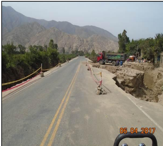
Erosión de la vía en la margen izquierda del km 19+750 al km 20+000
