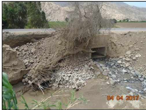
Pérdida de emboquillado y erosión de la fundación a la salida de la alcantarilla km 19+532
