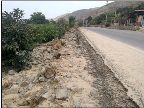
Erosión del talud, carril Derecho
