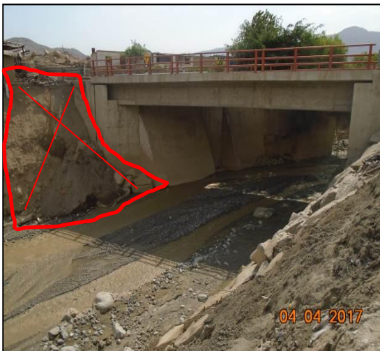
Socavación y arrastrado del enrocado de protección del estribo, en la salida del puente en el margen derecho del río. En el puente Lumbrá, km 21+500.
