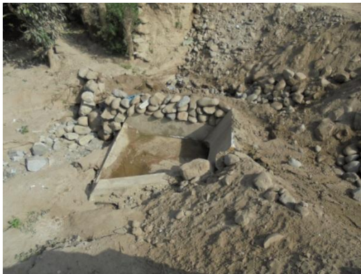
Pérdida del emboquillado de la alcantarilla km 19+854
