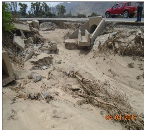
Socavación de la Alcantarilla Km 19+751
