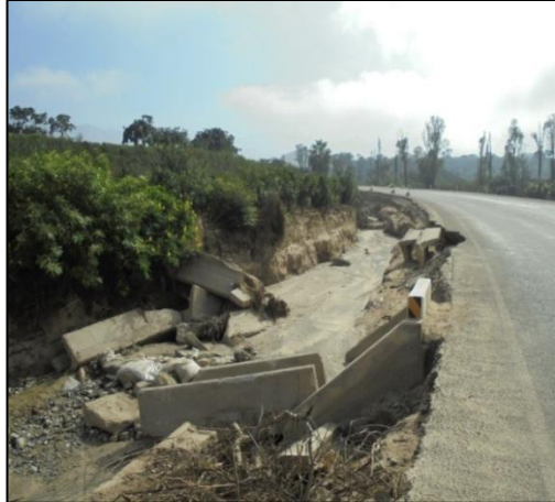
Pérdida de la estructura del canal y erosión de la plataforma km 19+758 al km 19+851
