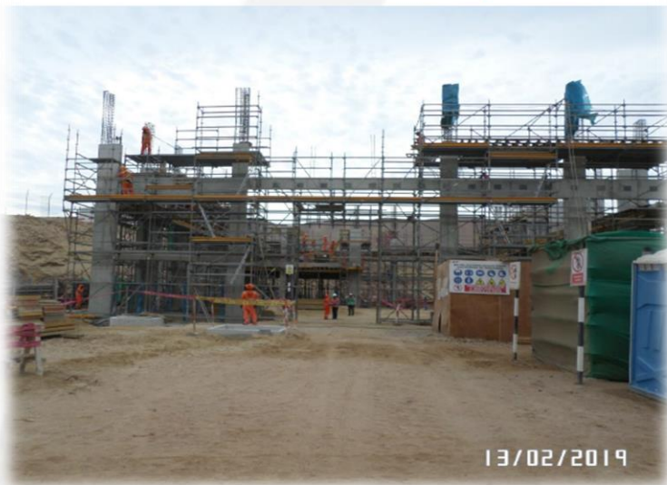
TALLER DE MANTENIMIENTO (IC-009)
