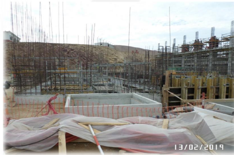
ESTACIÓN ELECTRICA PRINCIPAL (MS)
