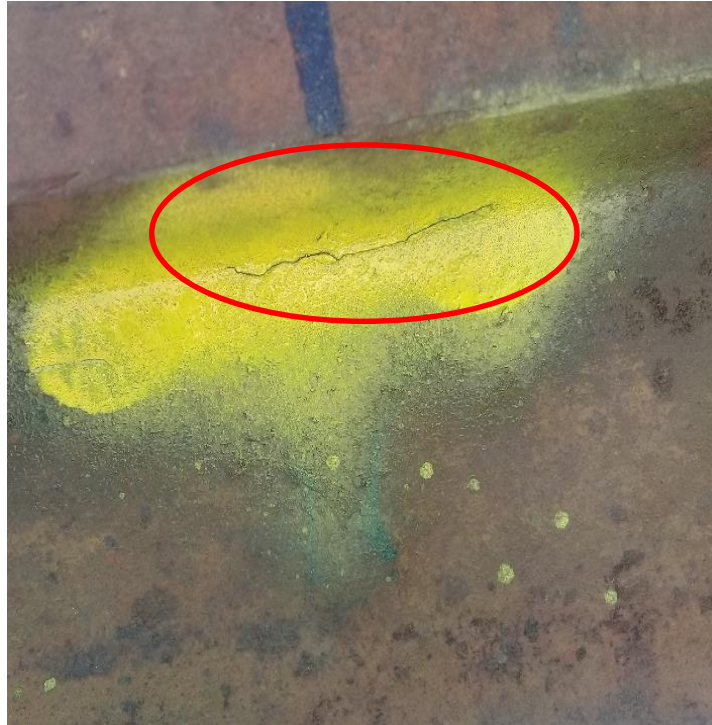
PK 138+116 (SUBD03): Head and Web Separation (Separacion Horizontal de Cabeza y Alma de Riel)
