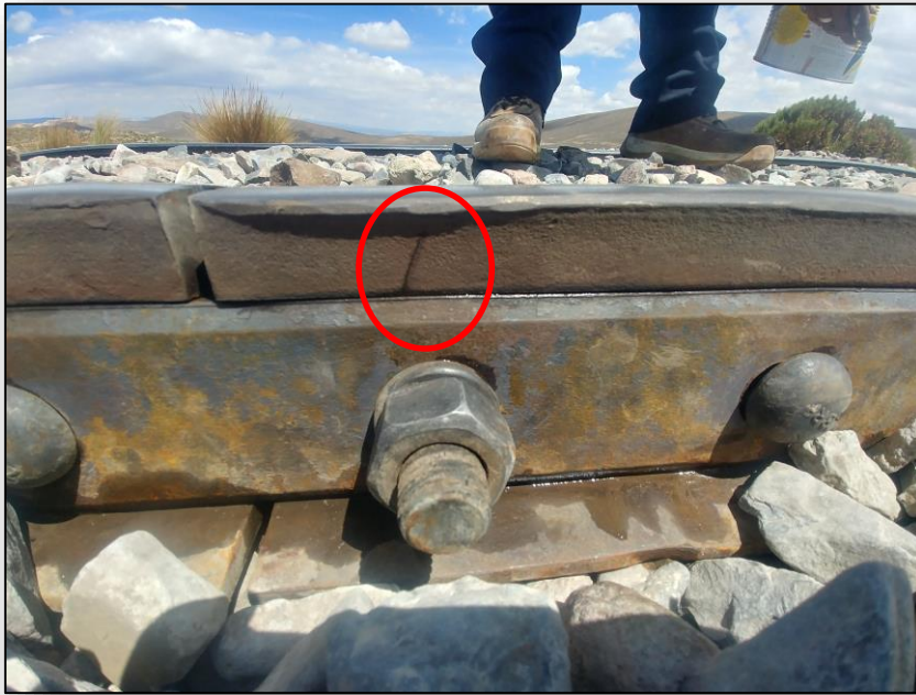
PK 137+450 (SUBD04): Transverse Fissure (Fisura Transversal)
