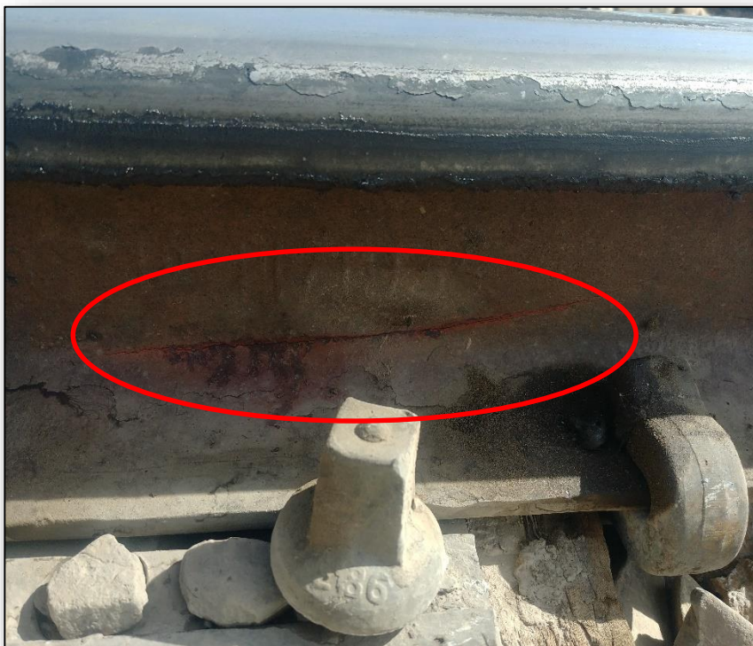
PK 132+720 (SUBD04): Slipt Web (Fisura en el Alma)
