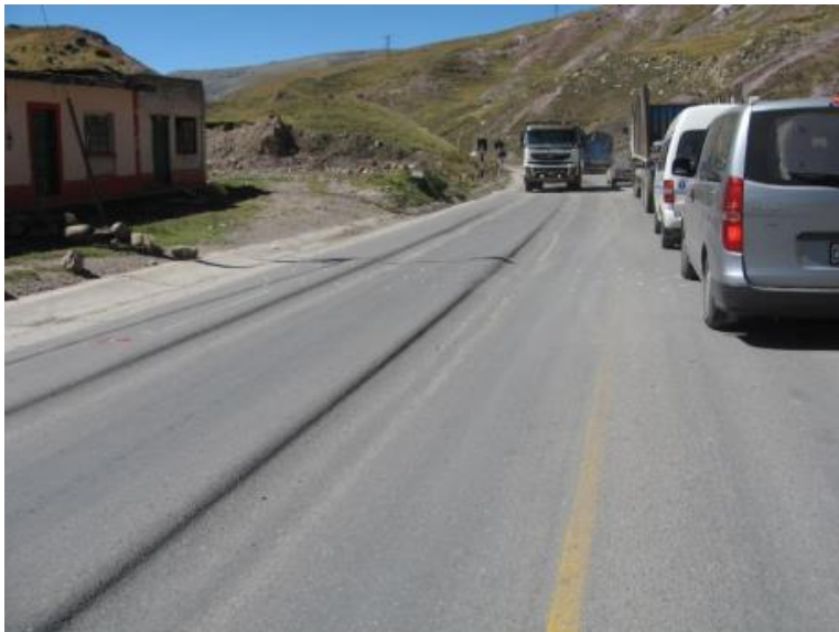
Ahuellamientos de hasta 11 cm
