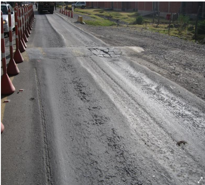
Ahuellamientos previo rompemuelle
