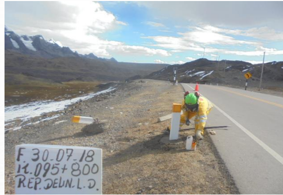
Deterioro delineador (cinta reflectiva)
