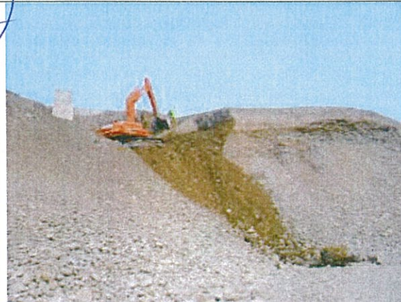
KM. 198+670 Sector en ejecución, avance de actividades de corte de material suelto. Vista S-N
