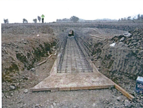
KM. 197+578 Alcantarilla tipo marco de C°A° de 1.00 m X 1.00 m en ejecución, solado y colocación de la armadura de refuerzo. Vista O-E
