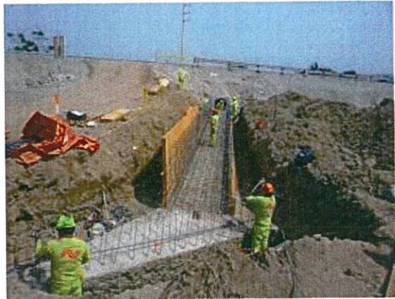
KM. 159+421 Alcantarilla tipo marco de C°A° de 1.00 m X 1.00 m en ejecución, solado y encofrado y de armadura de refuerzo de la losa inferior y muros. Vista E-O.
