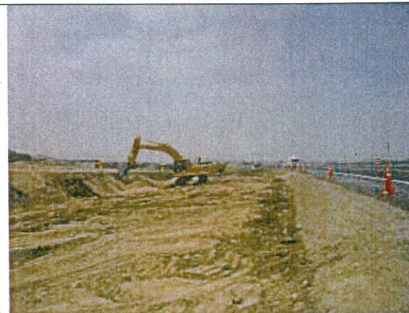
KM. 165+860 Sector en ejecución, corte de material suelto y eliminación de material excedente. Perfilado de talud. Vista N-S
