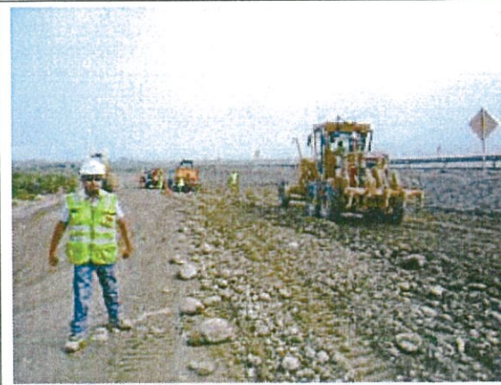
KM. 199+120 Sector en ejecución, conformación de plataforma con relleno compactado a nivel - 70 cm. Vista S-N
